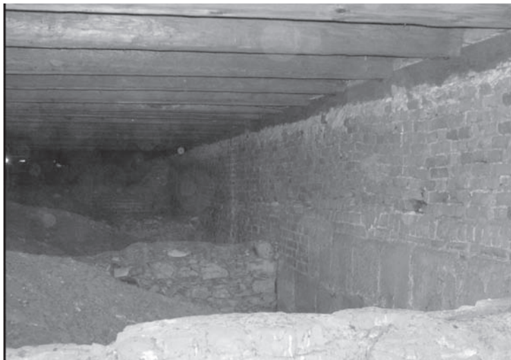
Fot. 1. Widoczne fazy budowy kościoła - poddasze, ściana nawy południowej (mur kamienny - faza II, nadbudowa ceglana - faza III). H. Landecka, 2008.
