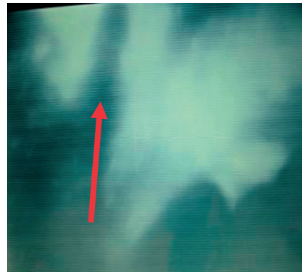
Rys. 8. Widoczne zakłócenia drożności przewodu wentylacji na poziomie VII-kondygnacji, podgląd kamerą wzornikową Monitor ORCUS.
