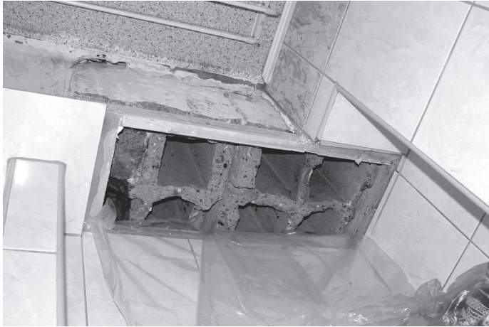
Rys. 6. Wentylacyjne kanały zbiorcze budynek prefabrykowany – samowolnie wyburzone. Fig. 6. Common ventilation ducts - a precast ventilation block removed by the thoughtless flat owner.
