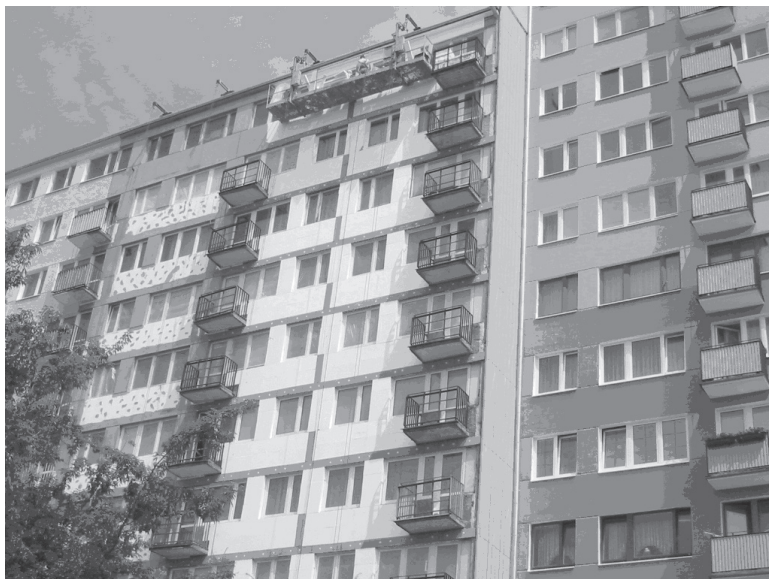
Rys. 2. System wielkopłytkowy, ocieplenie wykonano bez oceny stanu technicznego wieszaków, budynek: w I. etapie ocieplono – ściany szczytowe i filarki – metoda lekka-sucha, w II. etapie ocieplono: belko-ściany na fasadach i wymieniono ocieplenie na filarkach międzyokiennej – metoda BSO (styropian); zachowano detal podziału elewacji na filarki międzyokienne i belko-ściany); stan w 2003 roku.
