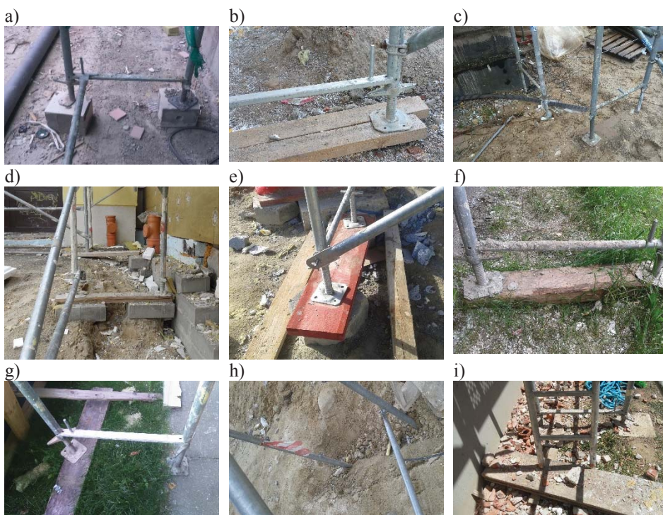
Rys. 3-7. Przykłady nieprawidłowego posadowienia rusztowań [zdjęcia – projekt ORKWIZ]
